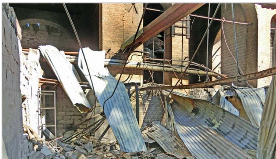
Nedrasat yttertak av korrugerad plåt i rådstugan. Inuti masugnsbyggnaden syns valvformiga rumsavskiljare och stödmurar. H-balken som syns i bild kan möjligen vara den traversbalk som användes för att lyfta och flytta gösarna.
