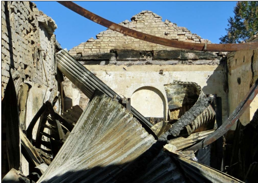
Maskinbusets inre. Hela yttertaket har rasat in efter branden. I rummets bortre del fanns tidigare blåsmaskinerna.
